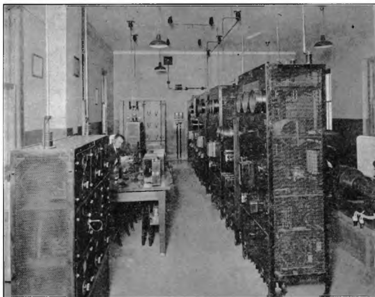
Interieur van de zendkamer op de bovenste verdieping van de Aeolian Building. De zenders van beide stations staan in het midden. Het zijn vier 500 watt lampzenders, voor ieder station twee. Een van de vier motor-generators is geheel rechts zichtbaar. Het groote schakelbord bevindt zich op den achtergrond links tegen den muur. Eén man kan door middel van eenige schakelaars en contrôle-apparaten, welke zich op de tafel bevinden, alle toestellen bedienen.
